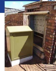
Old & new switch Kiosk
